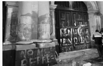
FIG. 18. DAÑOS OCASIONADOS POR MANIFESTACIÓN EN EL PALACIO DEL PODER LEGISLATIVO EDO. MEX. FUENTE: CATÁLOGO PHASE CERO.
