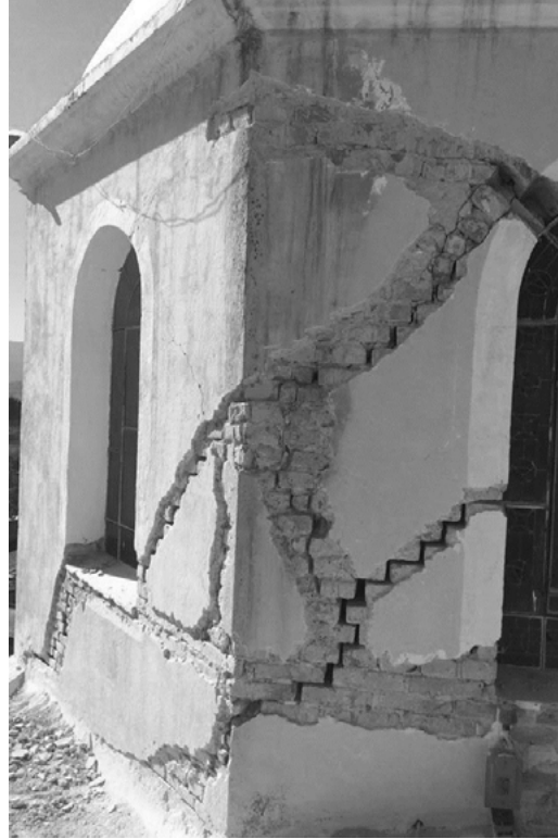
FIG. 1 GRIETA EN MUROS EN TORRE CAMPANARIO. FUENTE: CATÁLOGO PHASE CERO.
